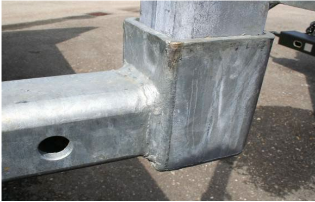
Výsvné klanice: zkontrolovat svary na praskliny.
