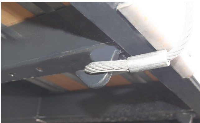
Háky pro uchycení lan: zkontrolovat svary na praskliny.
