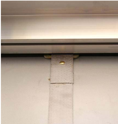
Laufrollen: Nieten auf Festsitz, Gurte auf Beschädigungen u. Risse prüfen
