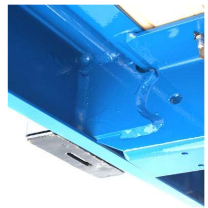
Rungenlager innen: Schweißnähte auf Risse prüfen
