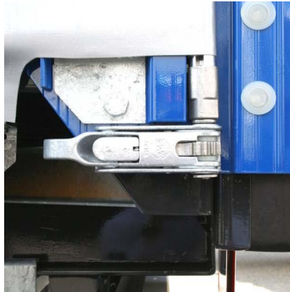
Spanngetriebe hinten: auf ordnungsgemäße Funktion prüfen, Adapter für Planenspannrohr auf Beschädigungen prüfen
