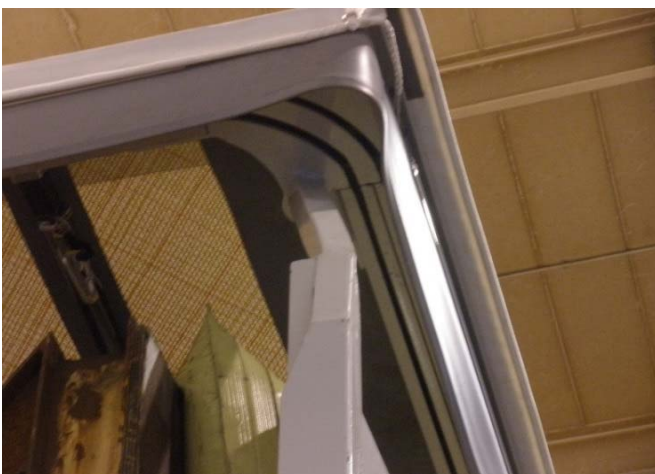
Bei Ausführung Edscha Eco in Verbindung mit fixer Rückwand Anbindung an Ecksäule hinten und Kurve auf Beschädigungen , Schweißnahttrisse etc. prüfen
