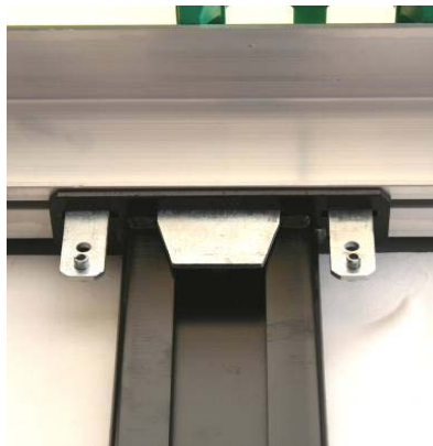
Laufwagen der Mittelsäulen: Nieten auf Festsitz prüfen
