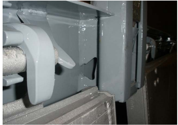
Rungenlager: Schweißnähte auf Risse prüfen
