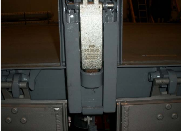
Rungenlager: Schweißnähte auf Risse prüfen, bewegliche Teile auf Verschleiß prüfen
