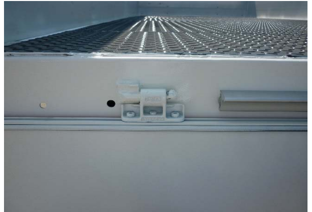
Scharnierkegel: Schweißnähte auf Risse prüfen
