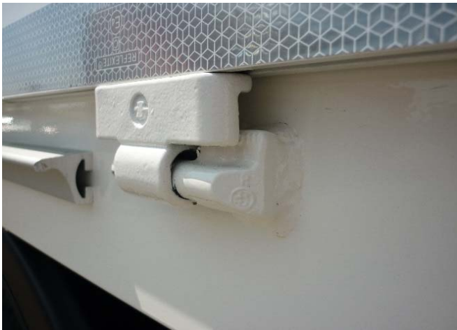
Scharnierkegel: Schweißnähte auf Risse prüfen
