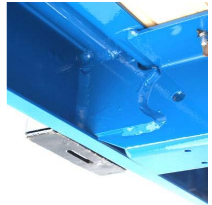
Rungenlager innen: Schweißnähte auf Risse prüfen
