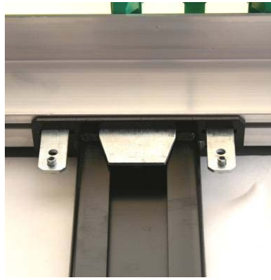
Laufwagen der Mittelsäulen: Nieten auf Festsitz prüfen
