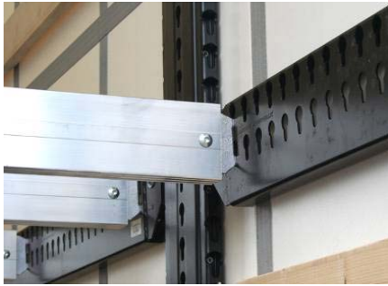
Tragbalken: Ordnungsgem. Zustand prüfen, Nieten auf Festsitz prüfen
