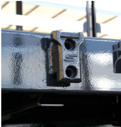
Rungenlager: Schweißnähte auf Risse prüfen
