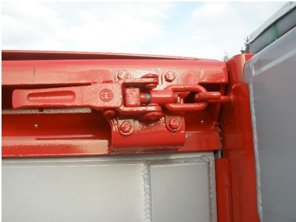
Blokada górnej poprzecznej belki ściany tylnej: sprawdzić pod kątem trzymania i poprawności działania
