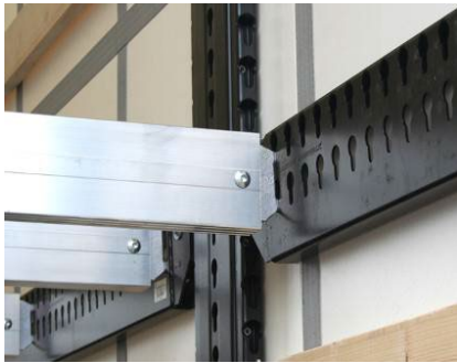
Belki nośne: sprawdzić prawidłowy stan oraz trzymanie nitów
