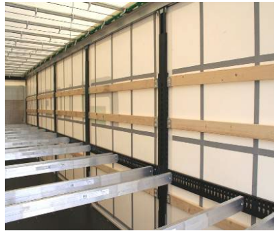
Boczna plandeka: sprawdzić spoiny pasów wzmacniających pod kątem pęknięć i uszkodzeń
