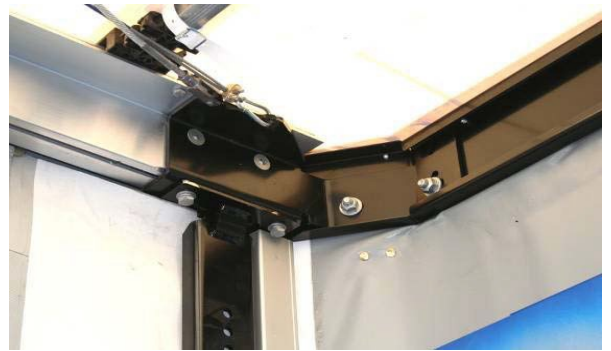
Dach z przodu: sprawdzić trzymanie śrub
