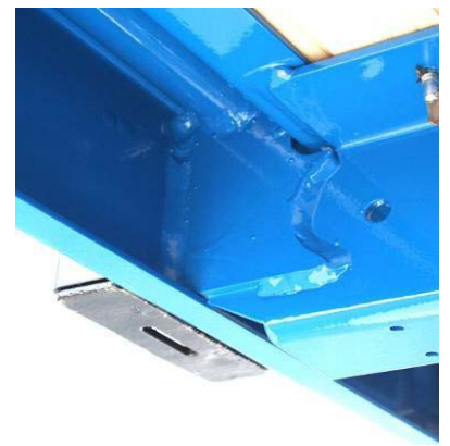
Uchwyt kłonicy od wewnątrz: sprawdzić spoiny pod kątem pęknięć
