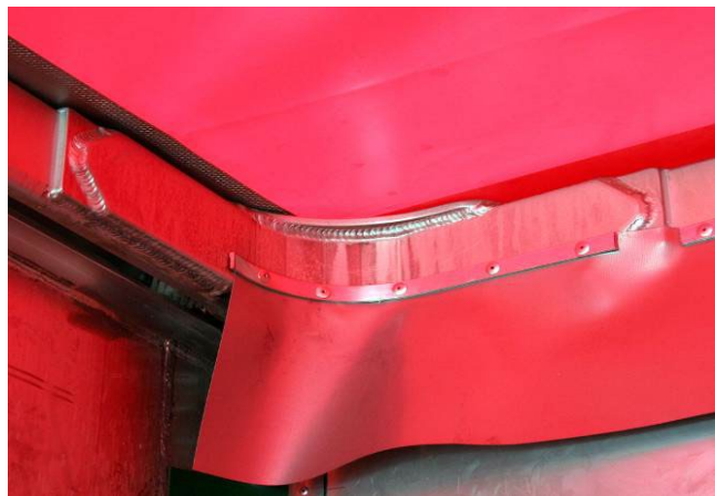
Mellfal belül: a mellfal és oldalfal közötti merevítés hegesztési varratait ellenőrizni kell, van-e rajta repedés
