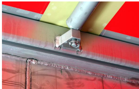
Konzol a tetőösszekötőhöz: hegesztési varratok ellenőrzése, van-e rajta repedés
