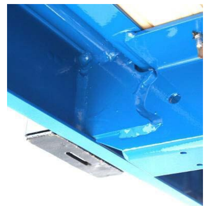
Oszlopszanér belül: hegesztési varraton van-e repedés
