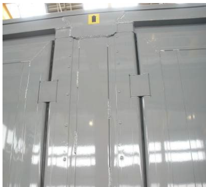
Středové sloupky: zkontrolovat upevnění nýtů, zkontrolovat řádnou funkčnost závěsů a příp. poškození, zkontrolovat řádné upevnění závěsů a případná poškození.
