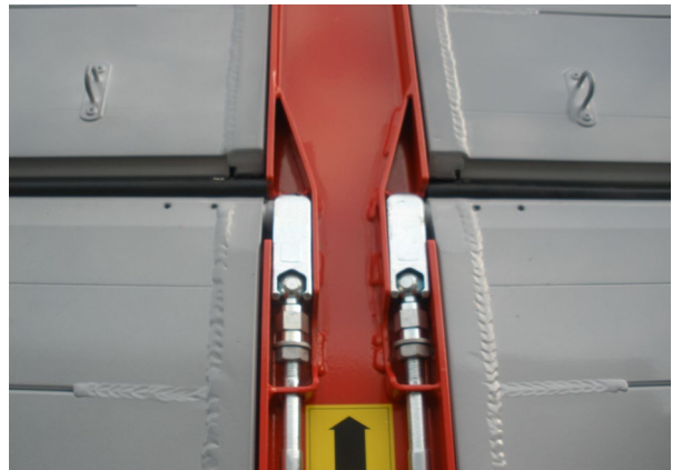
Bočnice z vnitřní i vnější strany: zkontrolovat svary na praskliny.
