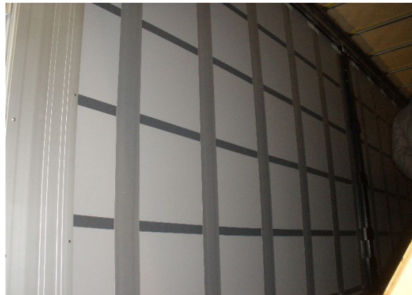
Posuvná plachta Rola-Safe: zkontrolovat ocelové pásy na deformaci.
