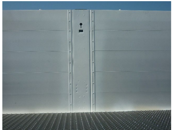
Bočnice: zkontrolovat upevnění nýtů.
