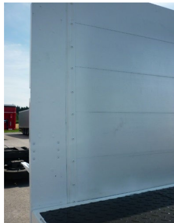
Bočnice: zkontrolovat upevnění nýtů.
