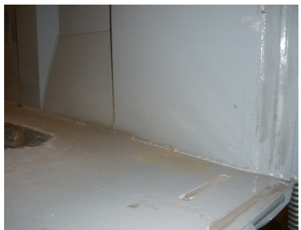
Innenseite: Schweißnähte auf Risse prüfen
