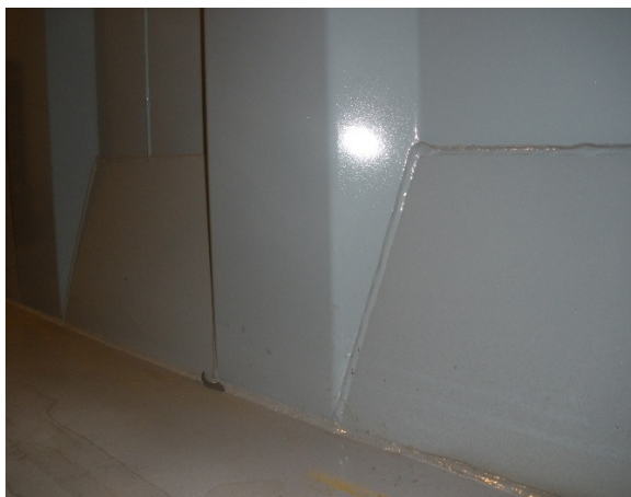
Versteifungen Innenseite: Schweißnähte auf Risse prüfen
