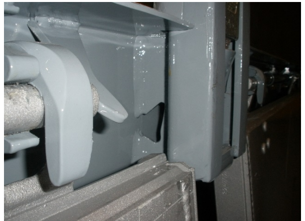
Rungenlager: Schweißnähte auf Risse prüfen
