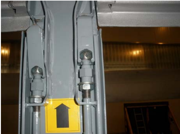
Verriegelung Pendelbolzen auf Spiel und Funktion prüfen
