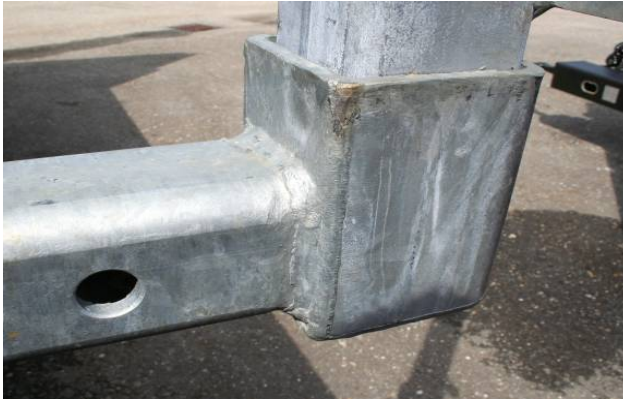
Auszieh-Rungen: Schweißnähte auf Risse prüfen
