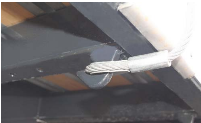
Gegenhaken für Seilspannrollen: Schweißnähte auf Risse prüfen
