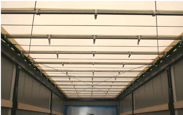
Seile und Seilanbindung: Auf Beschädigung und ordnungsgemäße Funktion prüfen
