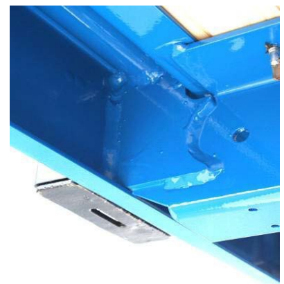
Rungenlager innen: Schweißnähte auf Risse prüfen
