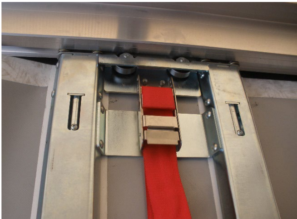
Laufwagen oben und unten auf Funktion und Verschleiß prüfen. Alle Nieten und Schrauben auf Festsitz prüfen
