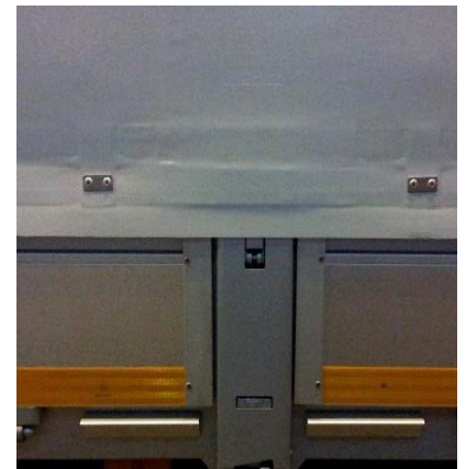
Quick-Slide-Spanner: Nieten auf Festsitz, Gurte und Spannelemente auf Beschädigung und Risse prüfen
