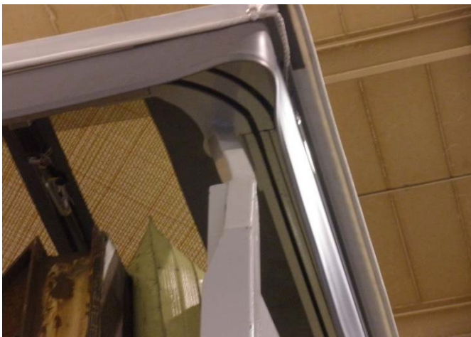
Bei Ausführung Edscha Eco in Verbindung mit fixer Rückwand: Anbindung an Ecksäule hinten und Kurve auf Beschädigungen, Schweißnahttrisse etc. prüfen
