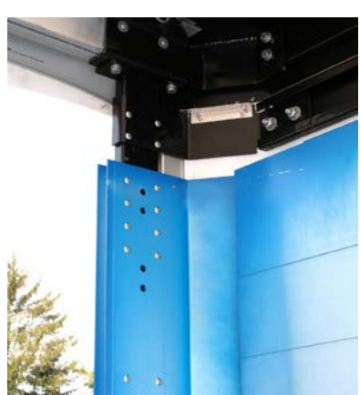
Ecksäulen vorne: Nieten auf Festsitz prüfen
