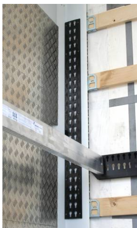
Ecksäule vorne: Nieten der Schiene auf Festsitz prüfen
