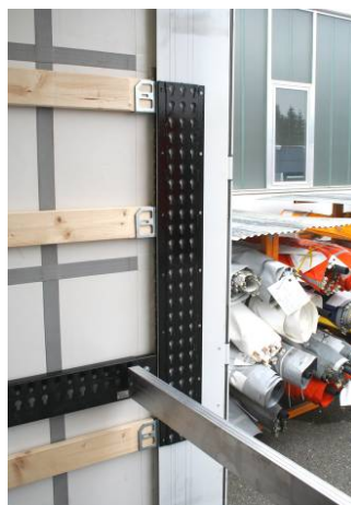
Ecksäule hinten: Nieten der Schiene auf Festsitz prüfen
