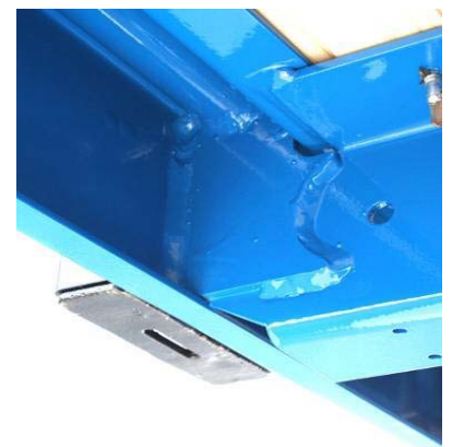
Rungenlager innen: Schweißnähte auf Risse prüfen
