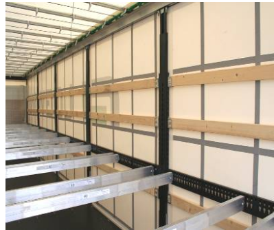
Seitenplane: Schweißnähte der Gurtverstärkungen auf Risse und Beschädigungen prüfen
