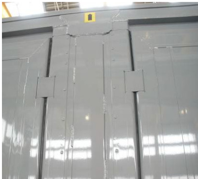
Słupki środkowe: sprawdzić trzymanie nitów i śrub, sprawdzić zawiasy pod kątem poprawności działania i uszkodzeń, sprawdzić mocowanie zawiasów pod kątem uszkodzeń i trzymania
