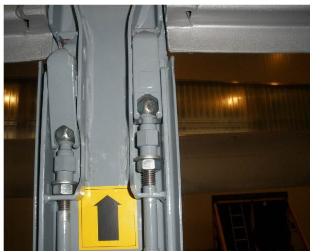
Ściana przednia, środkowy słupek/ środkowe słupki i słupki narożne z tyłu: sprawdzić poprawność działania blokady
