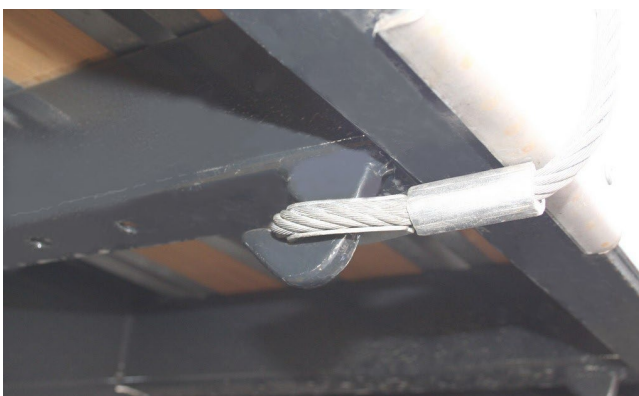
Zaczep hakowy rolek z liną naciągową: sprawdzić spoiny pod kątem pęknięć
