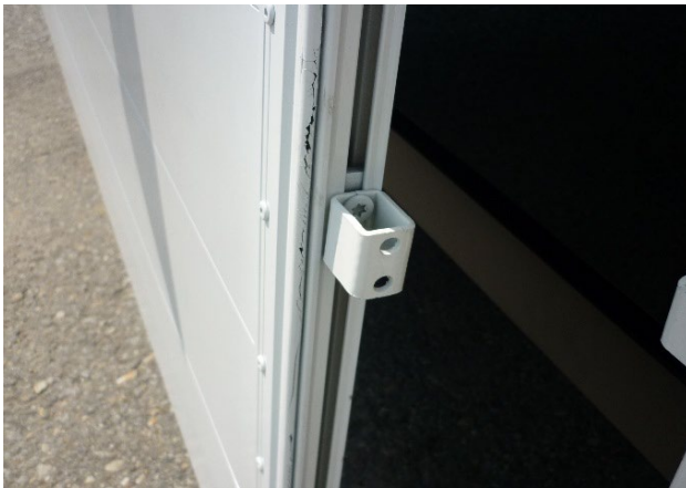
Sprawdzić trzymanie zapinacza i pod kątem uszkodzeń
