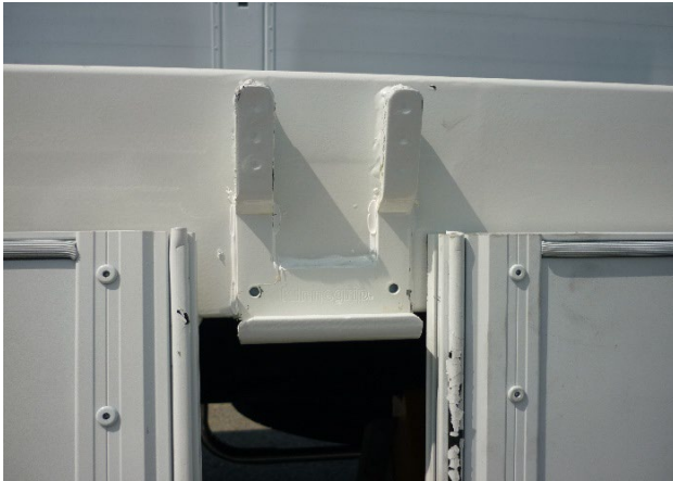
Uchwyt kłonicy: sprawdzić spoiny pod kątem pęknięć
