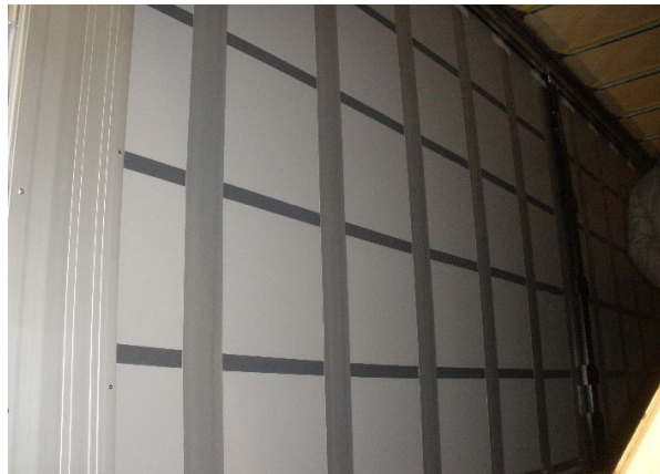
Kurtyna Rola-Safe: sprawdzić stalowe taśmy pod kątem odkształceń
