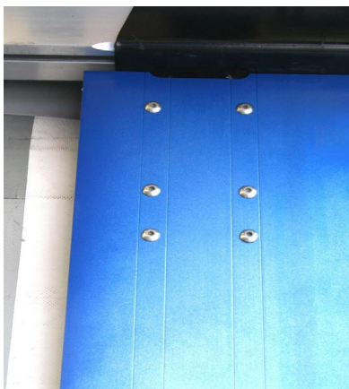
Tylne słupki narożne: sprawdzić trzymaanie nitów
