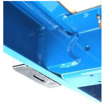
Kieszenie kłonic od wewnątrz: sprawdzić spoiny pod kątem pęknięć
