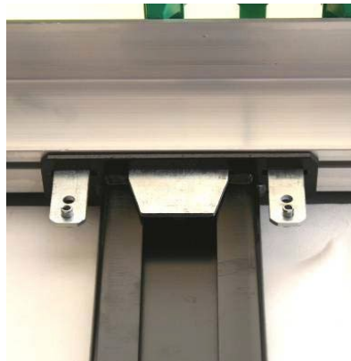
Wózki środkowych słupków: sprawdzić trzymanie nitów
