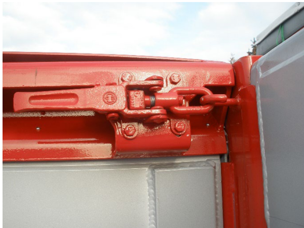
Zárszerkezet a hátsó ajtó felső keresztgerendáján: rögzítettség és megfelelő működés ellenőrzése
