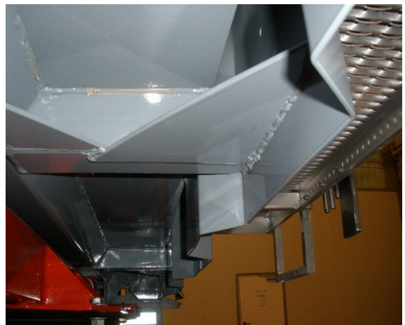
Hegesztési varratok ellenőrzése, van-e repedés
