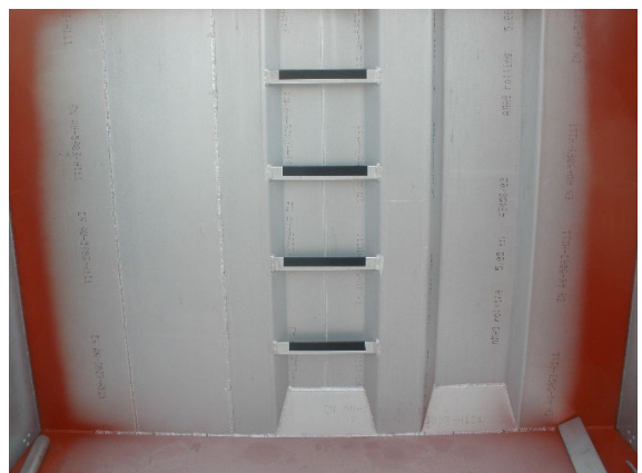
Belső oldal: varratok ellenőrzése, van-e repedés
