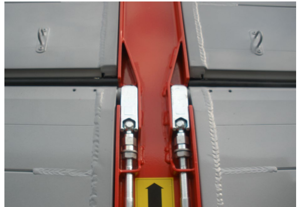
Oldalajtók kívül és belül: hegesztési varratok ellenőrzése, van-e repedés
