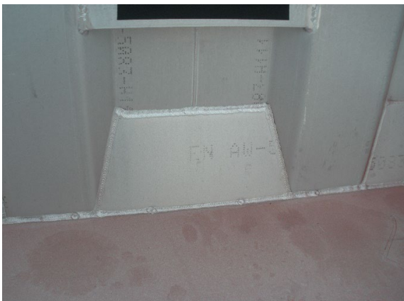
Merevítés belső oldala: varratnál van-e repedés
