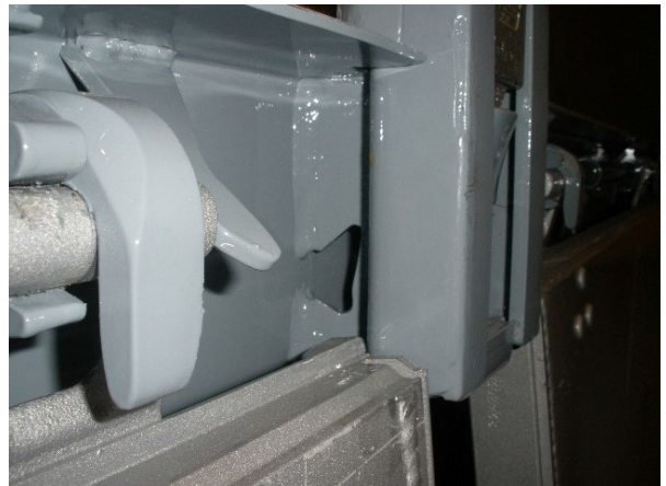
Oszlopzsánér: hegesztési varratok ellenőrzése, van-e repedés
