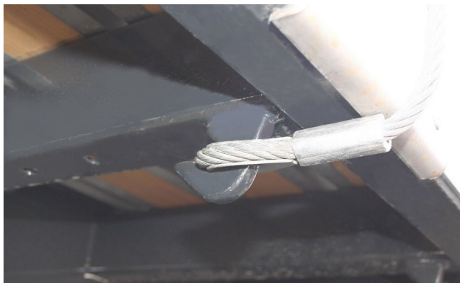
Kampó a drótkötél feszítéshez: hegesztési varratoknál ellenőrizni, van-e rajta repedés
