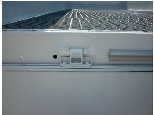
Zsanérok megfelelő működésének ellenőrzése, ill. van-e rajtuk sérülés. A zsanércsap hegesztési varratainál ellenőrizni kell, van-e rajta repedés
