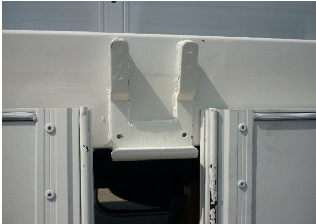
Oszlopzsánér: a hegesztési varratnál ellenőrizni kell, van-e rajta repedés
