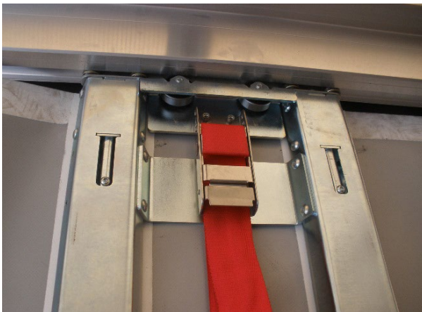
Futókocsik működését alul és felül, kopottságukat ellenőrizni. Szegecsek és csavarok megfelelő rögzítettsége
