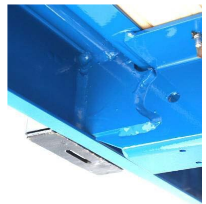
Oszlopzsánér belül: hegesztési varraton van-e repedés
