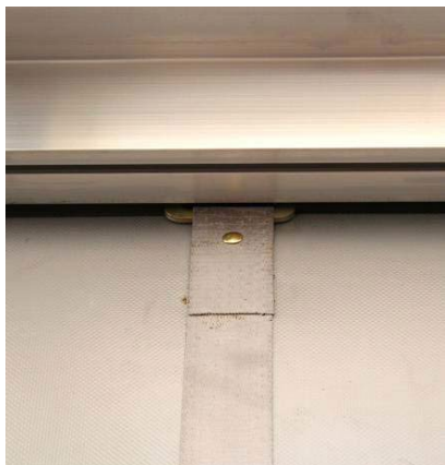
Futógörgők: szegecsek megfelelő rögzítettsége, hevederek épsége, illetve van-e valahol repedés
