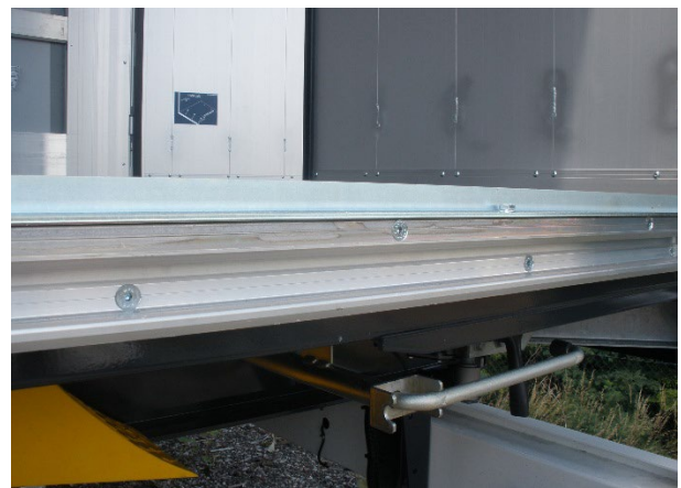
Alsó vezetősín működését, kopottságát ellenőrizni, csavarok rögzítettségét ellenőrizni
