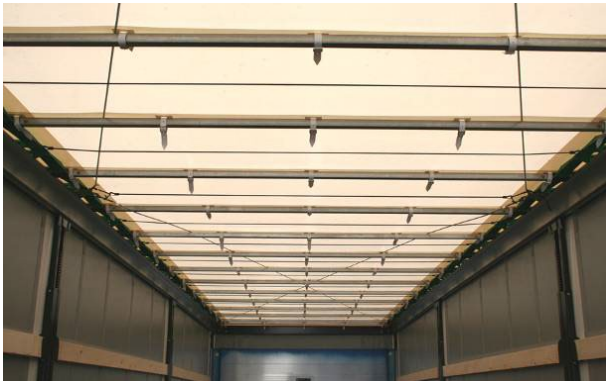
Drótkötél és csatlakozásai: megfelelő működés ellenőrzése, ill. van-e rajta sérülés
