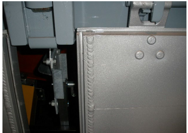
Bočnice: zkontrolovat svary na praskliny.
