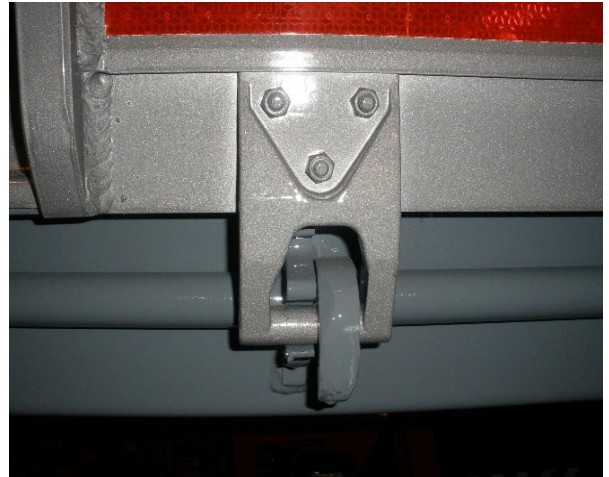
Závěsy: zkontrolovat svary na praskliny a upevnění šroubů.
