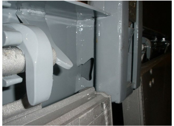
Uložení sloupků: zkontrolovat svary na praskliny.
