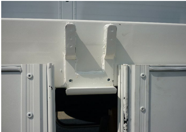
Uložení sloupků: zkontrolovat svary na praskliny.
