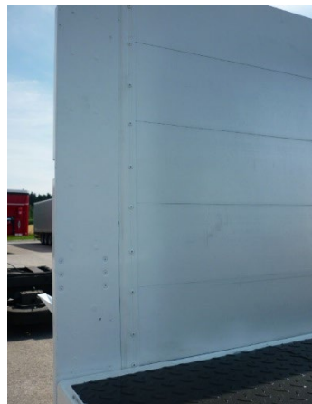
Bočnice: zkontrolovat upevnění nýtů.
