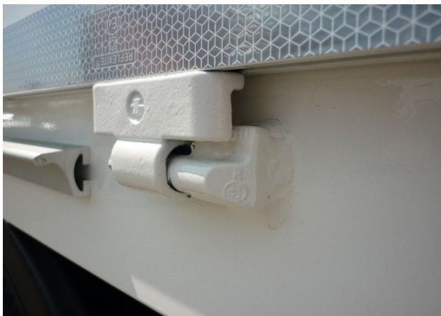
Závěsy: zkontrolovat řádnou funkčnost a stav opotřebení. Uchytení závěsů: zkontrolovat svary na praskliny.
