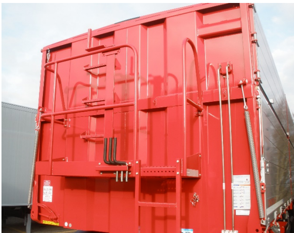
Sämtliche Schweißnähte auf Risse prüfen, Verschlüsse, Scharniere etc.: Sichtprüfung Allgemeinzustand
