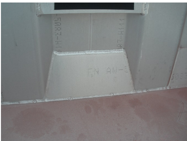
Verstärkungen Innenseite: Schweißnähte auf Risse prüfen
