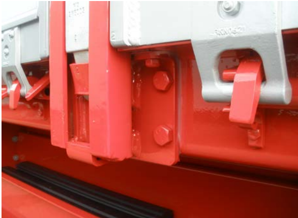
Rungenlager: Schweißnähte auf Risse prüfen, bewegliche Teile auf Verschleiß und Schrauben auf Festsitz prüfen
